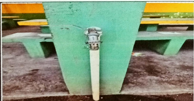
Foto 5: Sustrucción de llave de cheque
